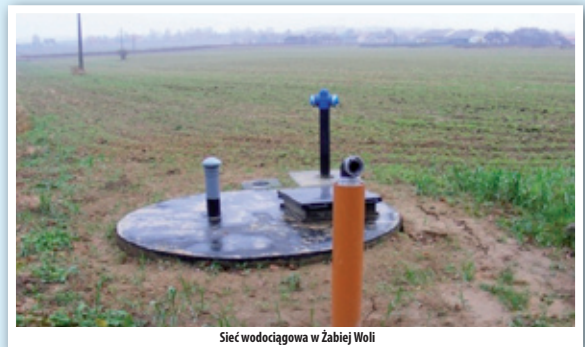
Sieć wodociągowa w Żabiej Woli
