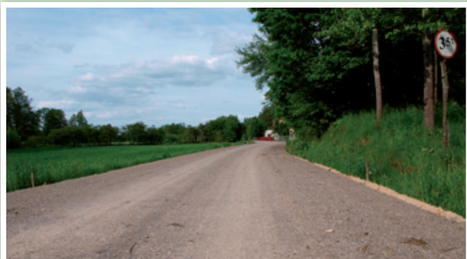
To już ostatni etap przebudowy tej drogi wraz z połączeniem jej z drogą powiatową Strzyżewice-Zakrzówek
