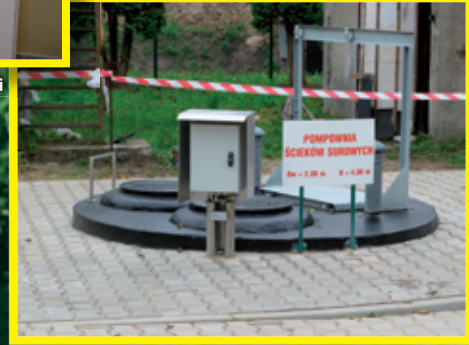
Pompownia ścieków surowych
