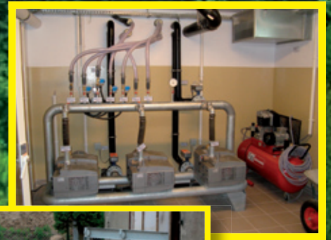
Zestaw dmuchaw w budynku technologicznym oczyszczalni
