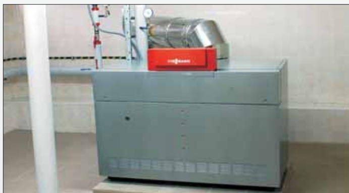
Kotłownia gazowa w Szkole Podstawowej w Kielczewicach
